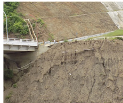
Acceso al puente DISA. (Tormenta tropical Nate. Noviembre 2017). Telpaneca. Fuente: El 19 Digital.
