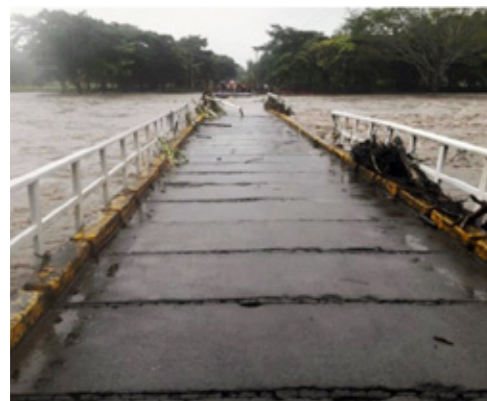
Puente de río Sapoá. Carretera NIC-66. Tramo Sapoá-Cárdenas. Proceso erosivo en talud. Carretera NIC-25. Fuente: Consorcio IDOM-NCG-METEOSIM-CON
