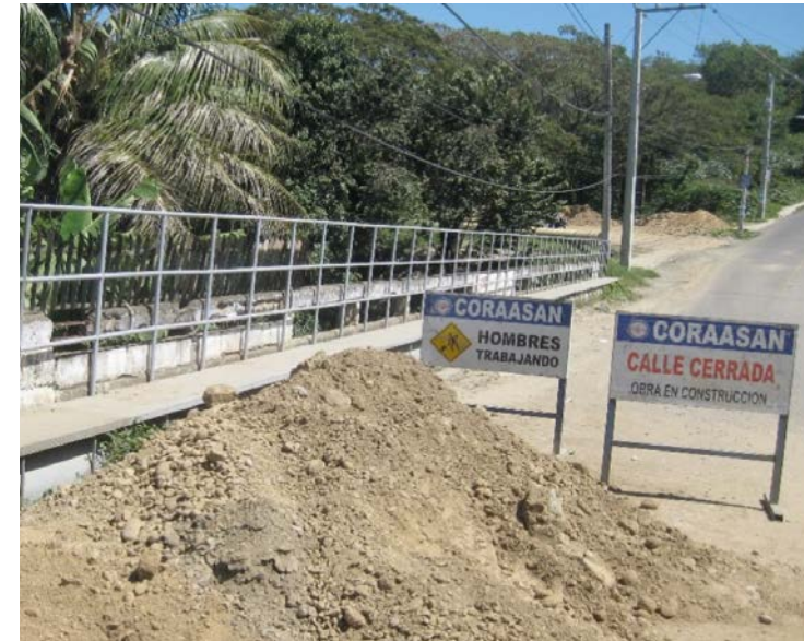
FIGURA 128. OBRA DE IMPULSIÓN DE LA EBAR ARROYO HONDO
