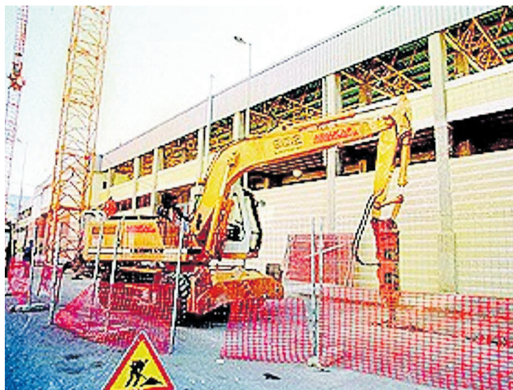
Las obras de ampliación de tribuna de El Madrigal en octubre de 1998.
